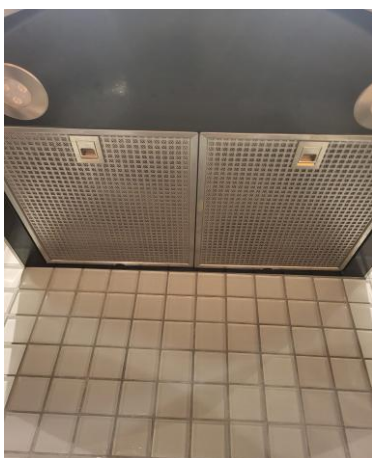
Bild 3 Filter i köpskåpan.
